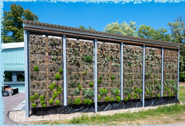
Fassadenbegrünung. (Foto: Sebastian Bischoff)
